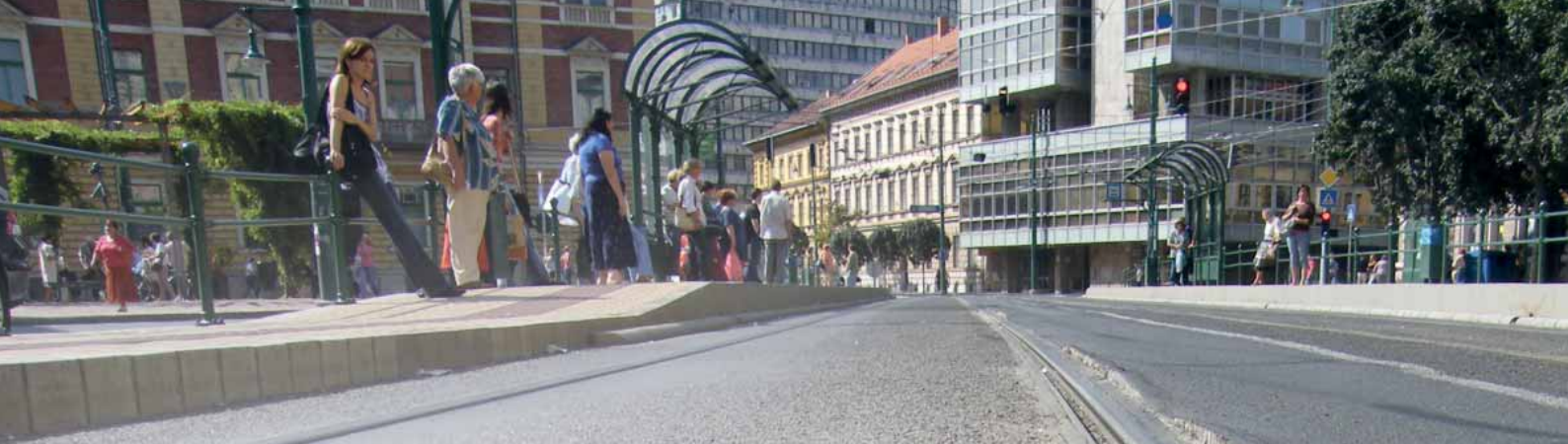
Nyomvályúsodás öntött aszfalt burkolaton (Anna-kút, Ortec-Isolast szerkezet 4 cm öntött aszfalt burkolattal, 2008-as építés)
